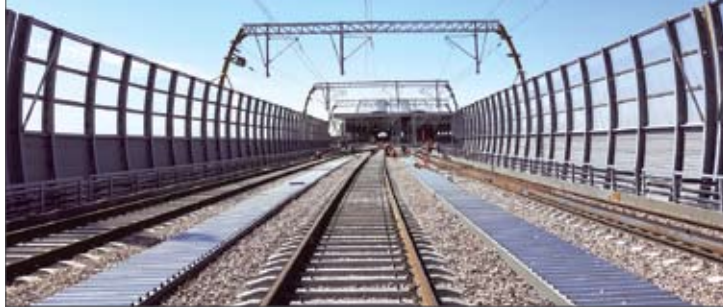
Эстакада. Вид изнутри. Шумозащитные экраны
